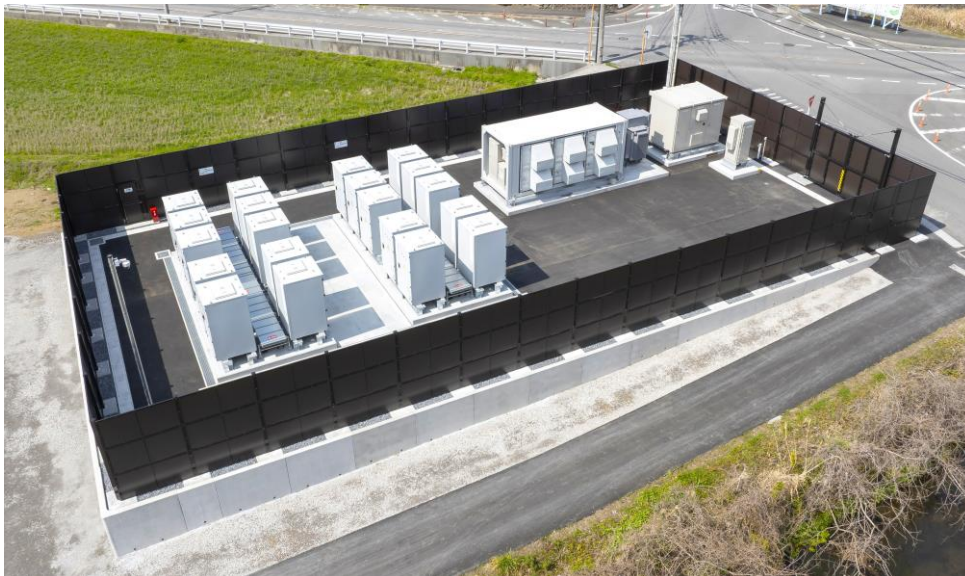
上頓野蓄電所
