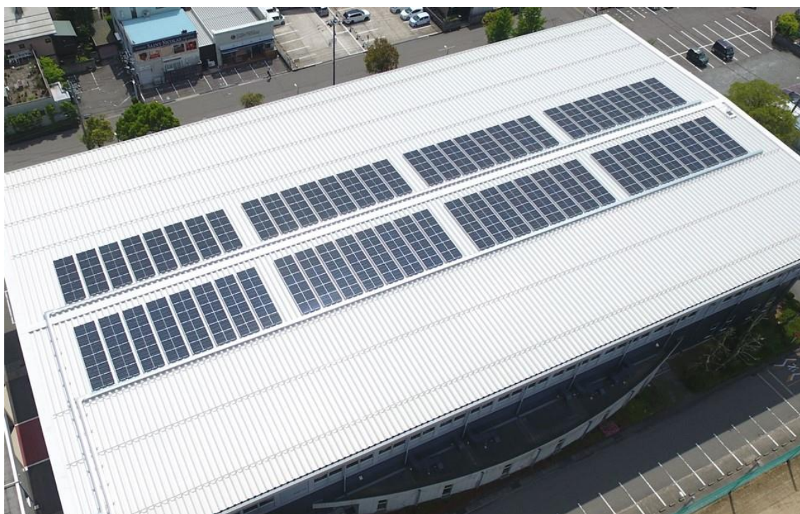
【直流で創る】太陽光発電（南校地 20 号館体育館（避難所）屋上）
