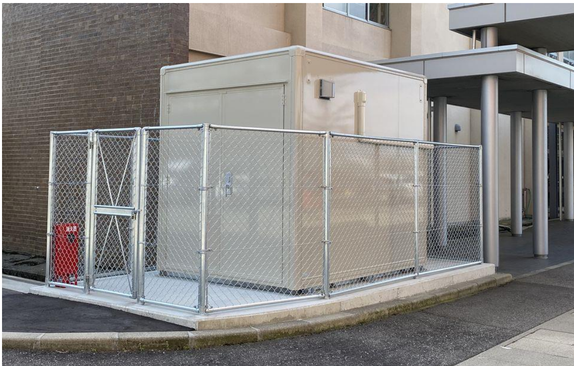
【直流で蓄める】蓄電コンテナ
