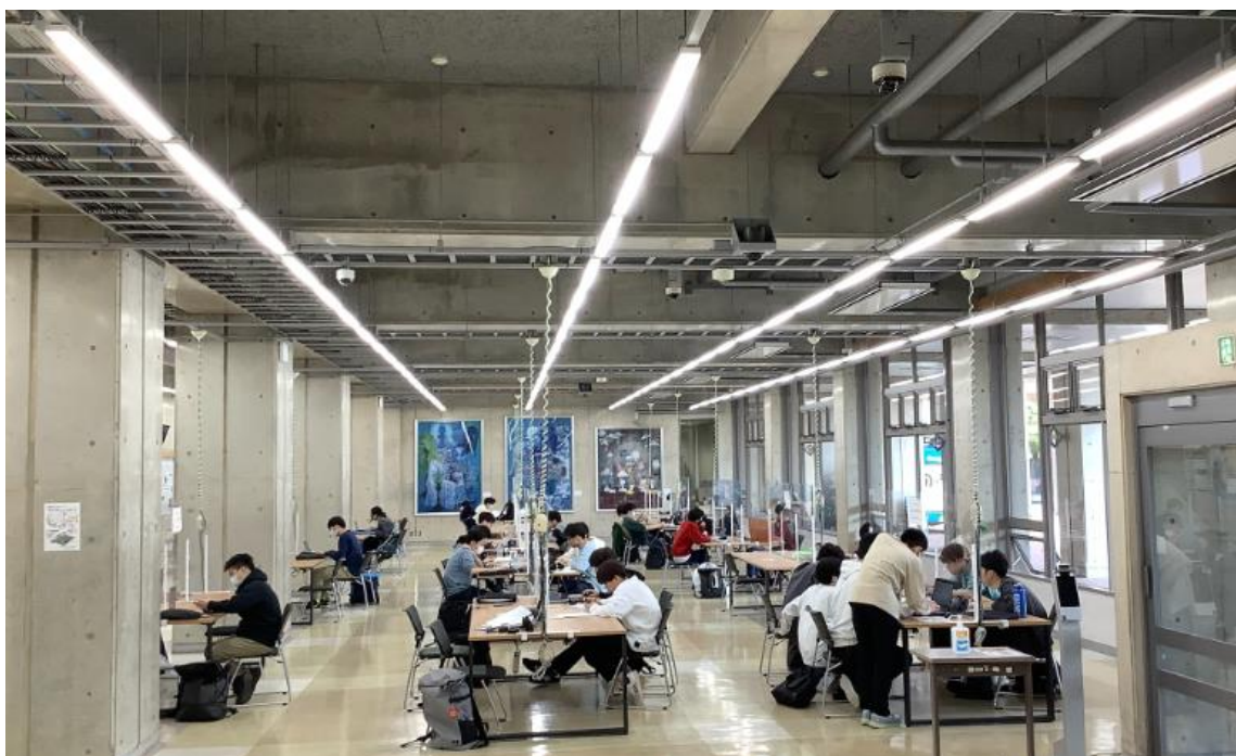
【直流で使う】LED 照明、ファンコイル（7 号館自習室）
