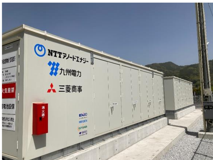
【福岡県田川郡香春町に設置した蓄電システム】
