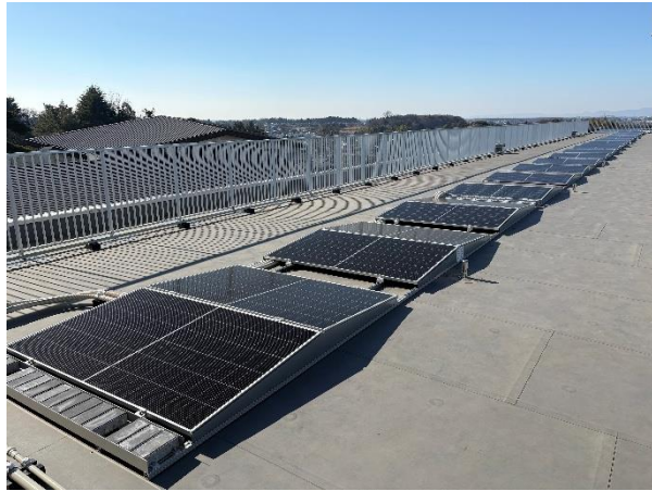
太陽光パネル
